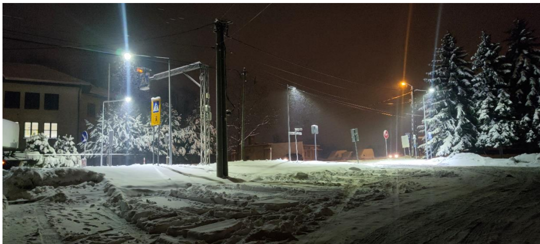
Ilustracja 11 Doświetlenie przejść dla pieszych przy drodze krajowej
