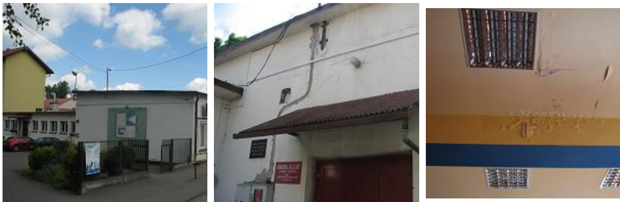
Ryc.4: Wymiana pokrycia dachowego, modernizacja i adaptacja budynku Ośrodka Kultury Gminy Tomice im. Wincentego Bałysa na bibliotekę i świetlicę szkolną Zespołu Szkolno-Przedszkolnego w Tomicach
